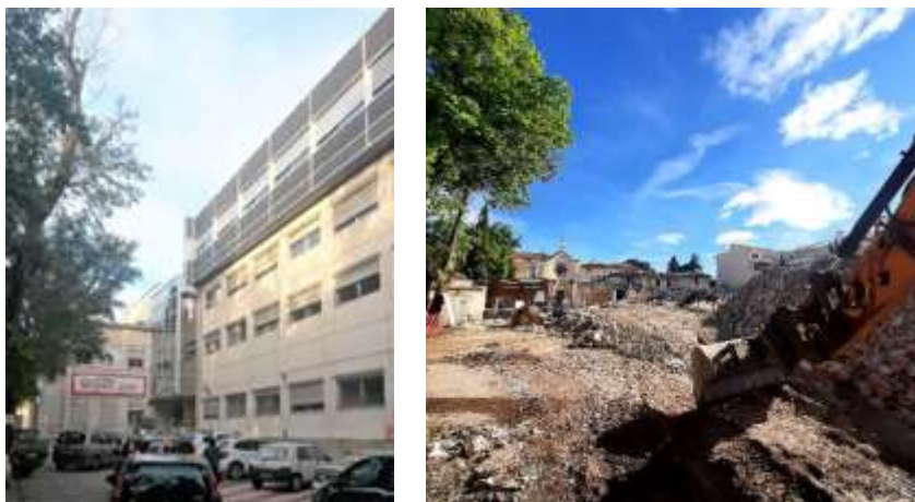
La Clinique Saint-Jean avant le début des travaux et en cours de démolition.
